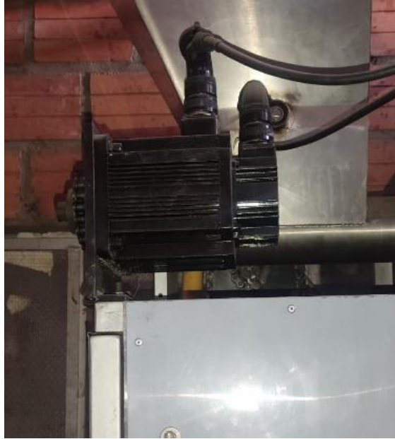
Figura 3. 32 MOTOR DE DOSIFICACIÓN DE PRODUCTO
