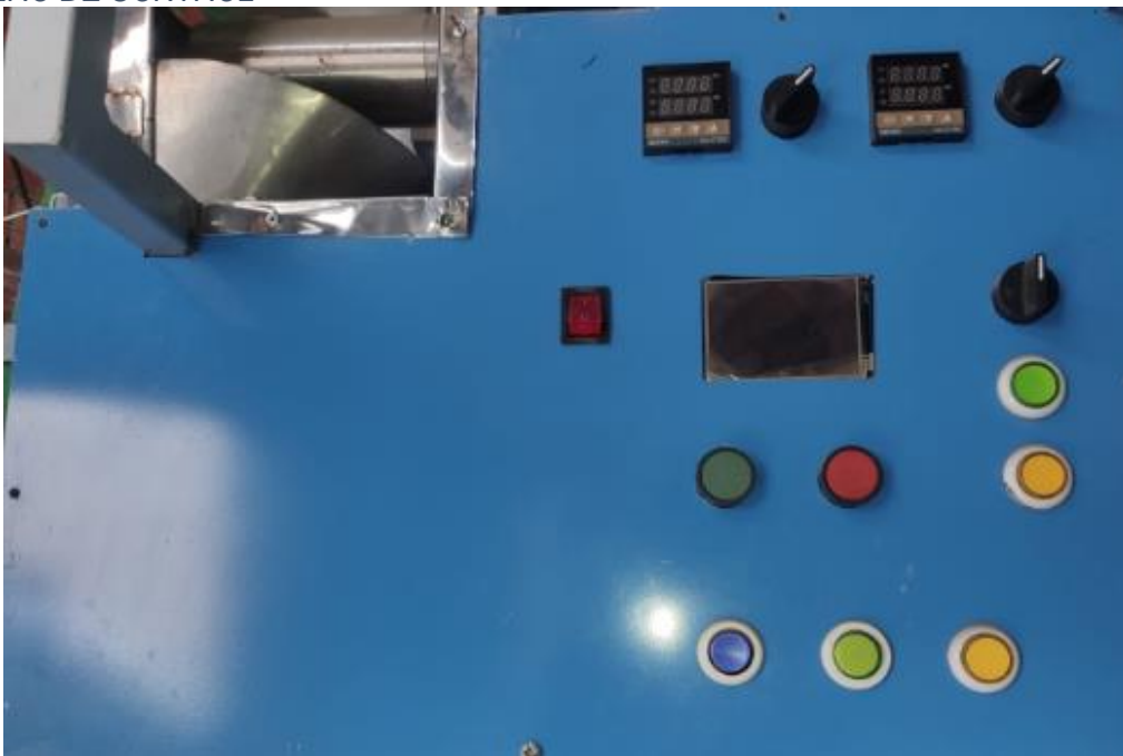
Figura 3. 31 TABLERO DE CONTROL
