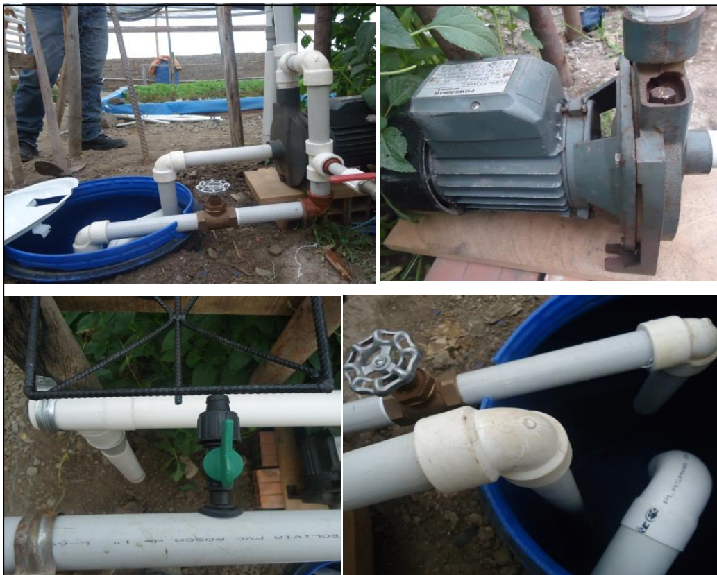
Figura 8. Componentes del riego automatizado
