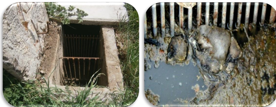
Foto 1. Sólidos gruesos en la cámara de rejilla.
