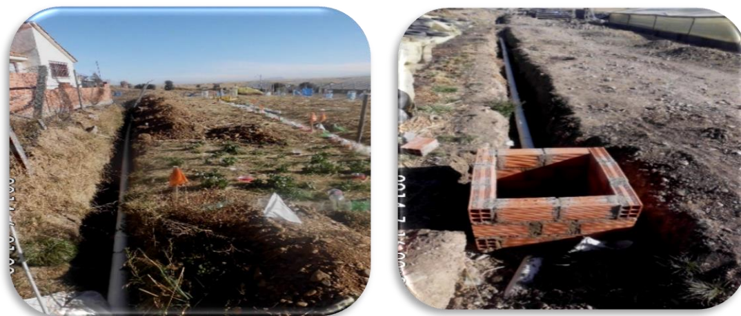
Figura 9. Detalle de las cámaras de distribución del agua residual a los estanques artificiales de ensayo
