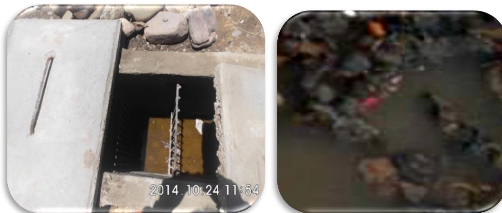
Figura 10. Detalle de las cámaras desarenadoras (retención de residuos sólidos)
