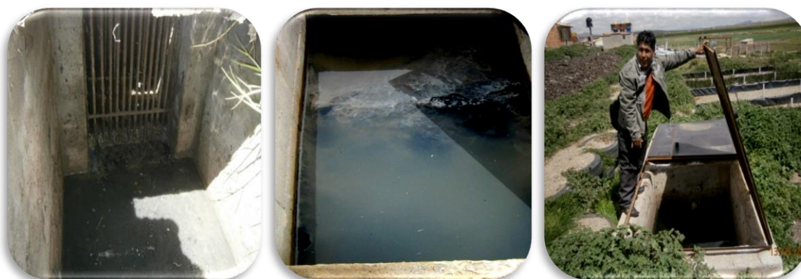
Foto 3. Desarenador con elementos sedimentables y cámaras de sedimentación.
