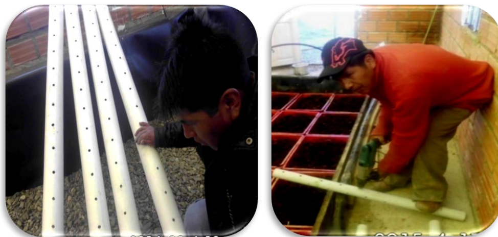
Figura 7. Detalle de los tubos de aireación mostrando las perforaciones de los mismos
