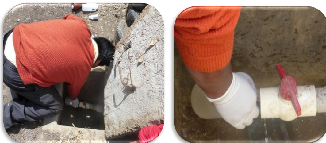
Figura 16. Cámara colectora de aguas tratadas
