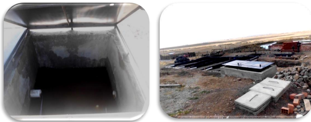
Figura 11. Detalle de las cámaras de sedimentación
