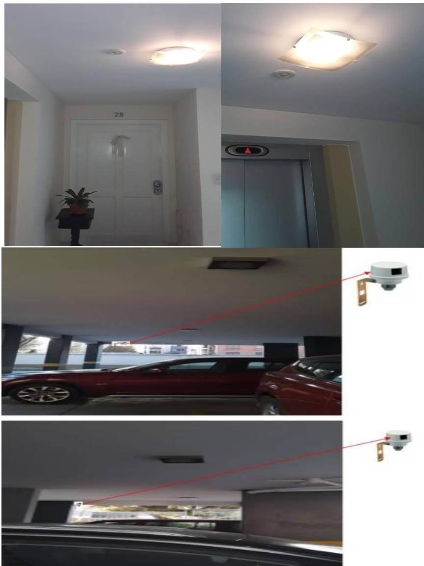
Figura N° 109. Pruebas de sensor de movimiento en sótano, planta baja y garaje A y B del Edificio Casa Blanca
