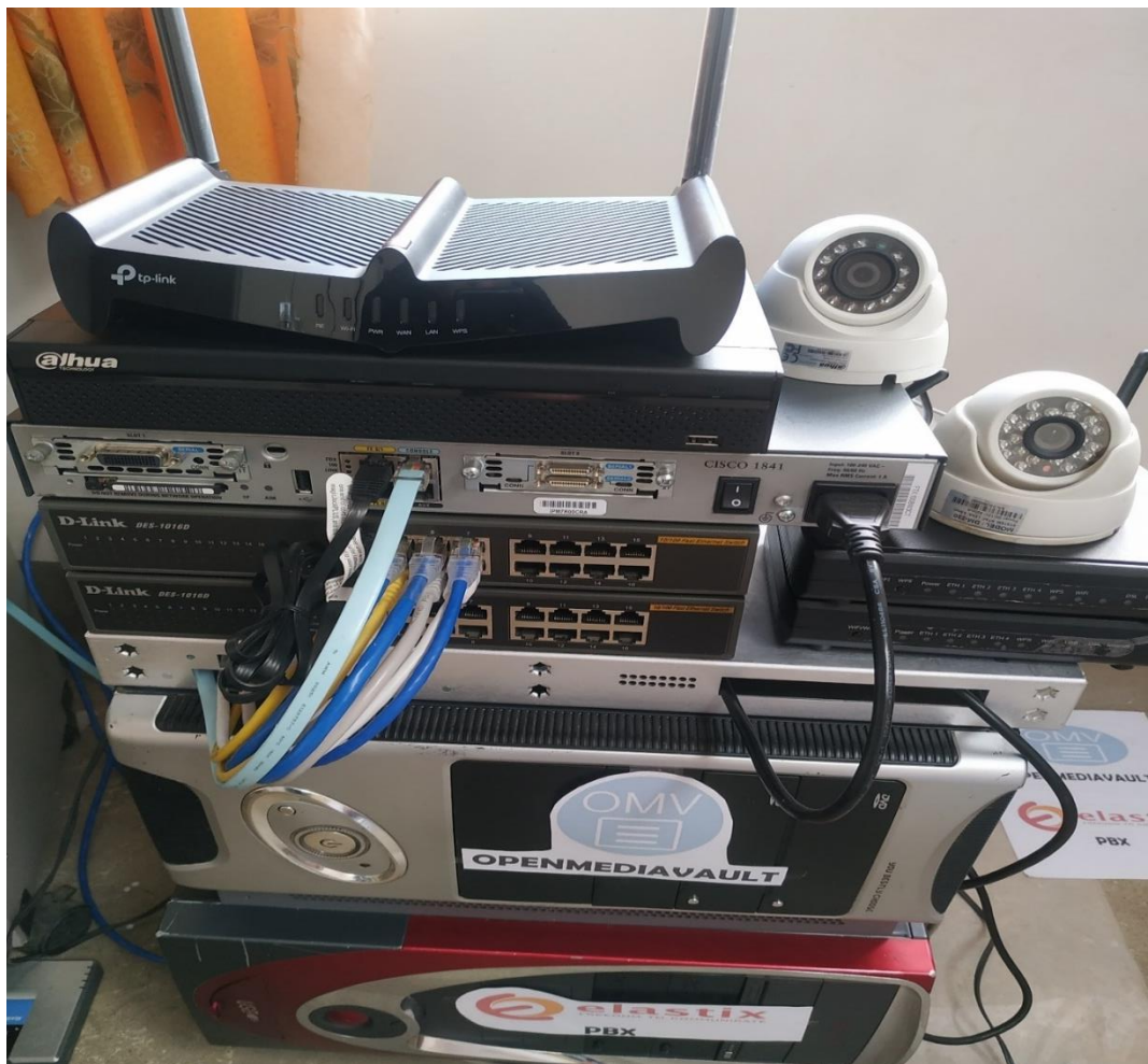
Figura N° 115. Red Local PBX, OMV, CCTV Wireless rompe muros dos repetidores
