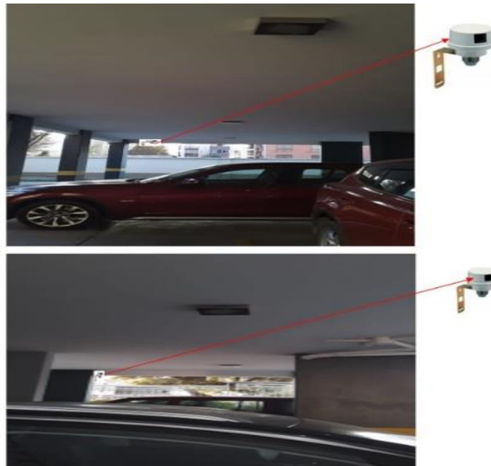
Fotografía N° 4. Relé fotoeléctrico RM10 control de iluminación
