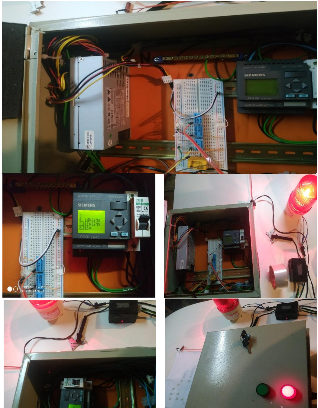
Figura N°112. Cuadro de control alarmas con logo siemens
