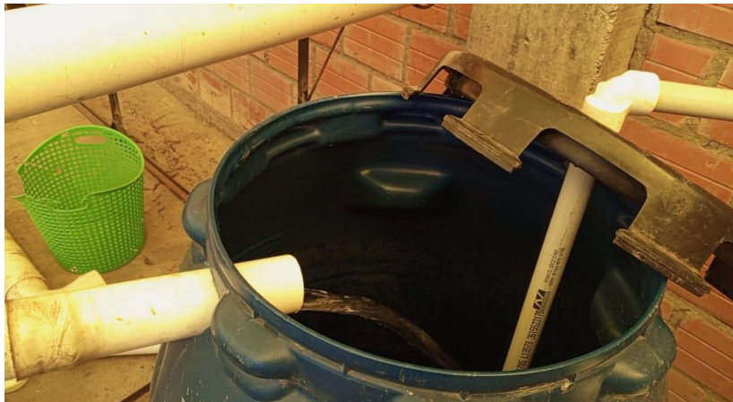
Anexo 6. Tanque de almacenamiento de la reciculacion de agua
