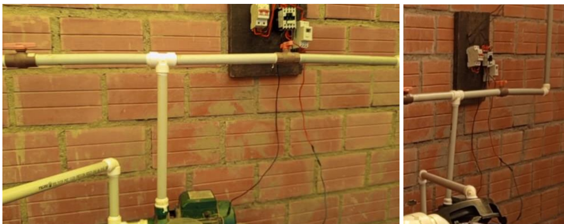
Figura 6. Componentes de riego automatizado
