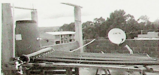
Fotografía 1. Colector Solar Plano con tubos de desagüe e instalada a la intemperie – La Paz.
