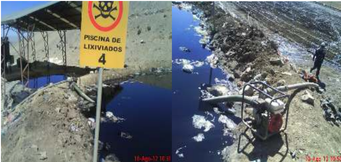
Cahuasa, Simón; recirculación de lixiviados en el interior del relleno sanitario sobre el espacio de terreno a lado de planta de tratamiento, fotografía 10 de Agosto de 2012.
