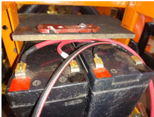
Figura 4.14 Cableado interno en el banco de baterías
