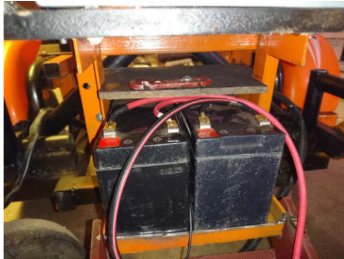
Figura A 20: Banco de baterías conectadas en serie
